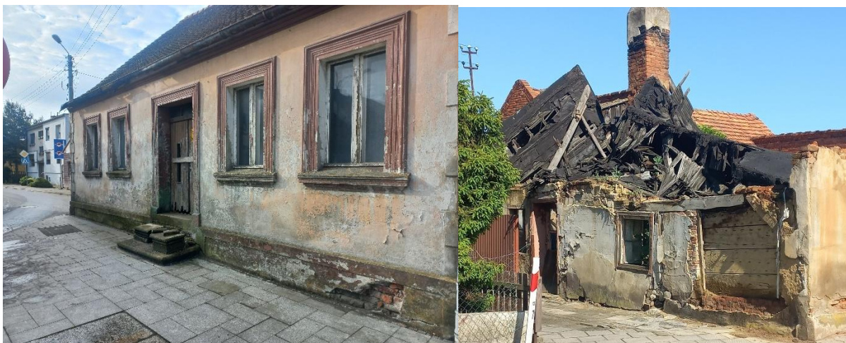
Ryc. 32. Zdegradowana zabudowa śródmiejska
